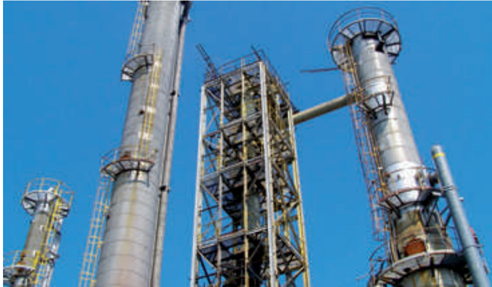
Odstavená druhá rectisolová řada ve Vřesové, na které k poruše došlo (foto SU)
