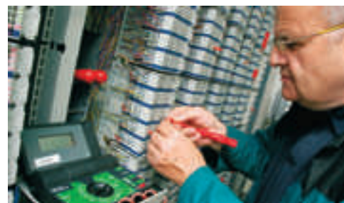
Mechanik Zdeněk Kutil při údržbě rozvaděče telefonní ústředny ve Vřesové (foto SU)
